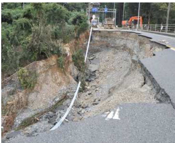
崩落した191号道路
